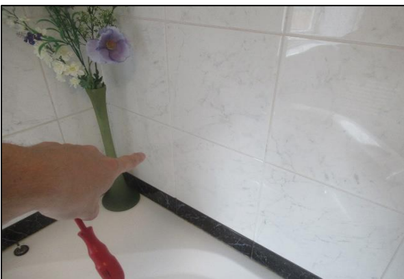
5. Holklinkende afwerkingen tpv badkamer.
