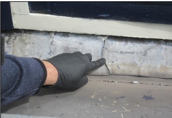
3. Scheur in loodwerk.
