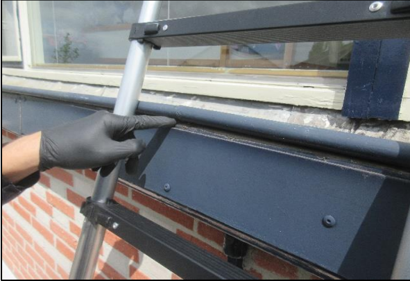
1. Goot is dermate gekanteld dat kiervorming zichtbaar is.
